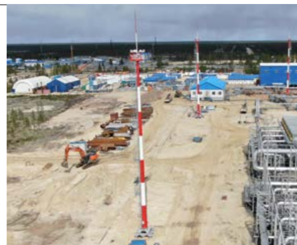
ДКС Еты-Пуровского месторождения ЯНАО
