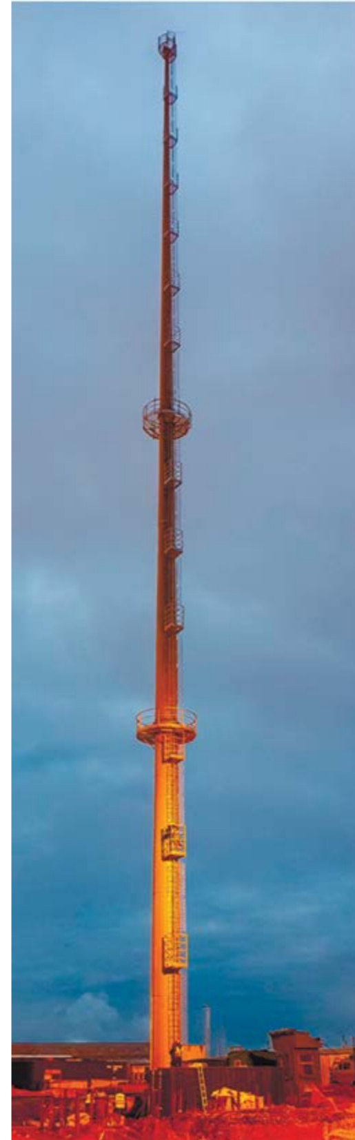
Молниезащитный комплекс 90 м Завод ПАО «Сибур», Тобольск
